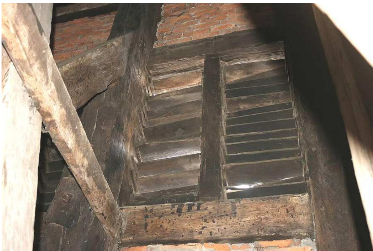
Fot. 7. Konstrukcja drewniana wewnątrz wieży, uszkodzona okiennica.
