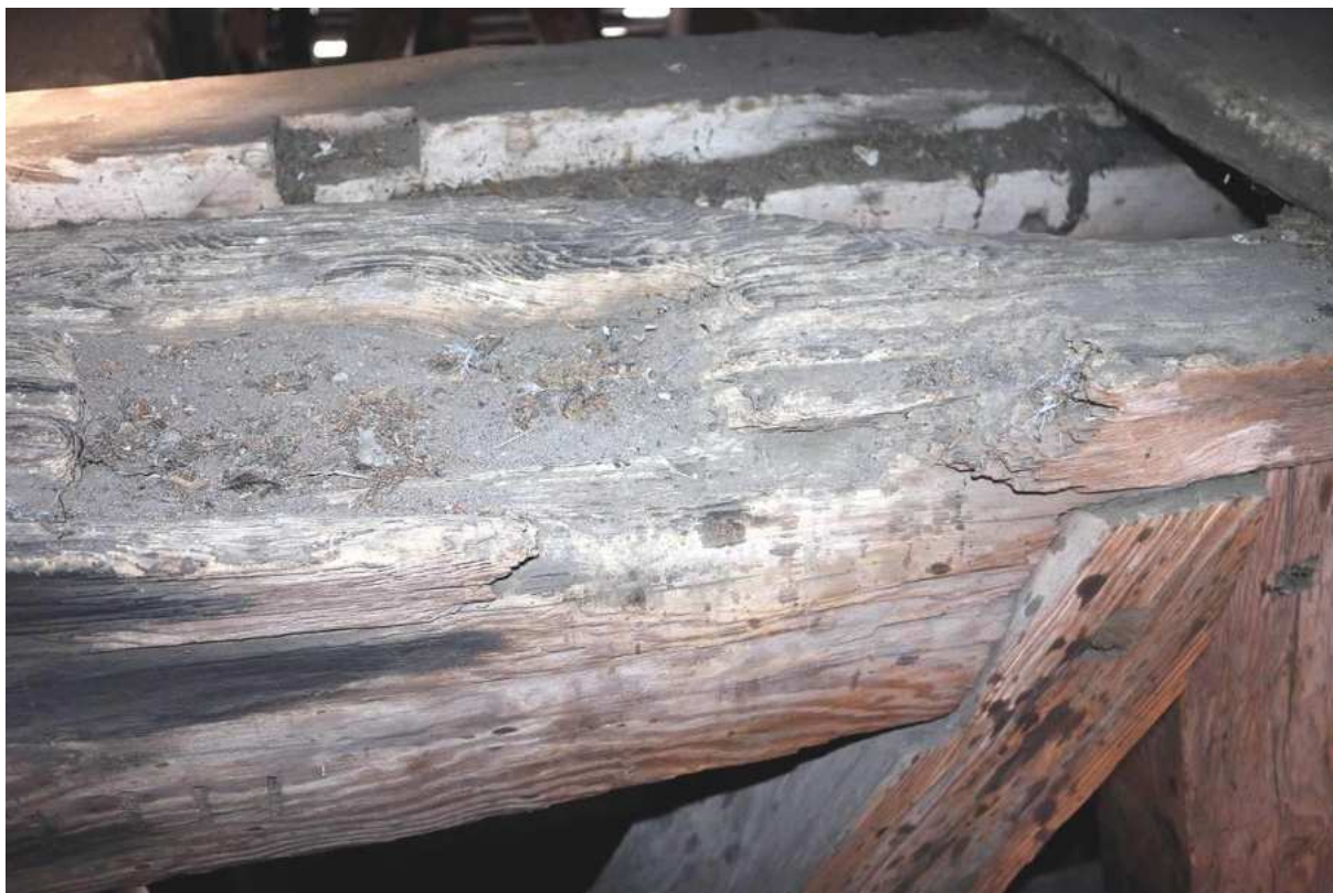
Fot. 10. Konstrukcja drewniana wewnątrz wieży - widoczne uszkodzenia drewna.
