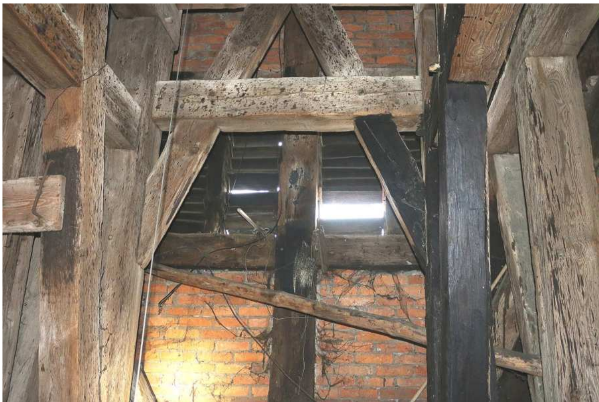
Fot. 6. Konstrukcja drewniana wewnątrz wieży, uszkodzona okiennica.
