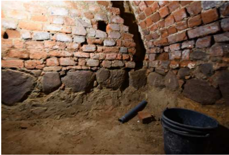
Fot. 1 kamienne posadowienie ścian wymagające podmurowania
