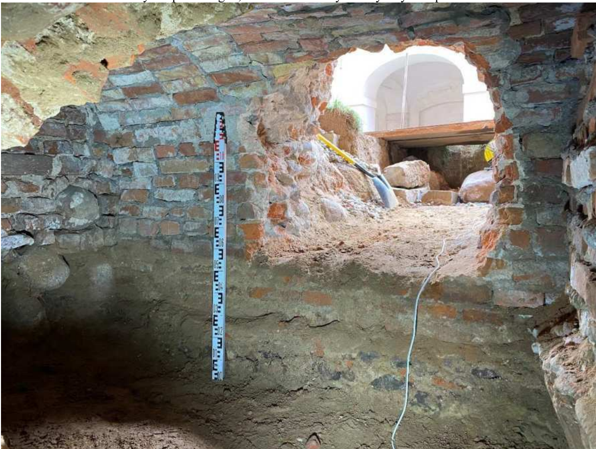
Fot. 3. Kazimierz Biskupi, kościół pw. Św. Jana Chrzciciela i Pięciu Braci Męczenników, krypta 7., stan zachowania: zasolenie lica ceglanego, wtórne zaprawy cementowe, współczesne cegły.
