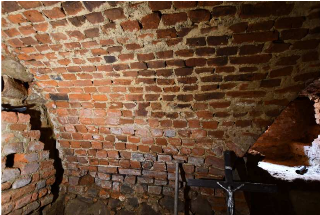
Fot. 1. Kazimierz Biskupi, kościół pw. Św. Jana Chrzciciela i Pięciu Braci Męczenników, krypta 1., stan zachowania: zasolenie lica ceglanego, ubytki spoin i cegieł, zachowane relikty historycznych zapraw.
