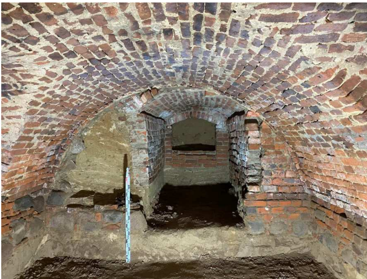
Fot. 4. Kazimierz Biskupi, kościół pw. Św. Jana Chrzciciela i Pięciu Braci Męczenników, krypta 2., stan zachowania: zasolenie lica ceglanego, ubytki lica.
