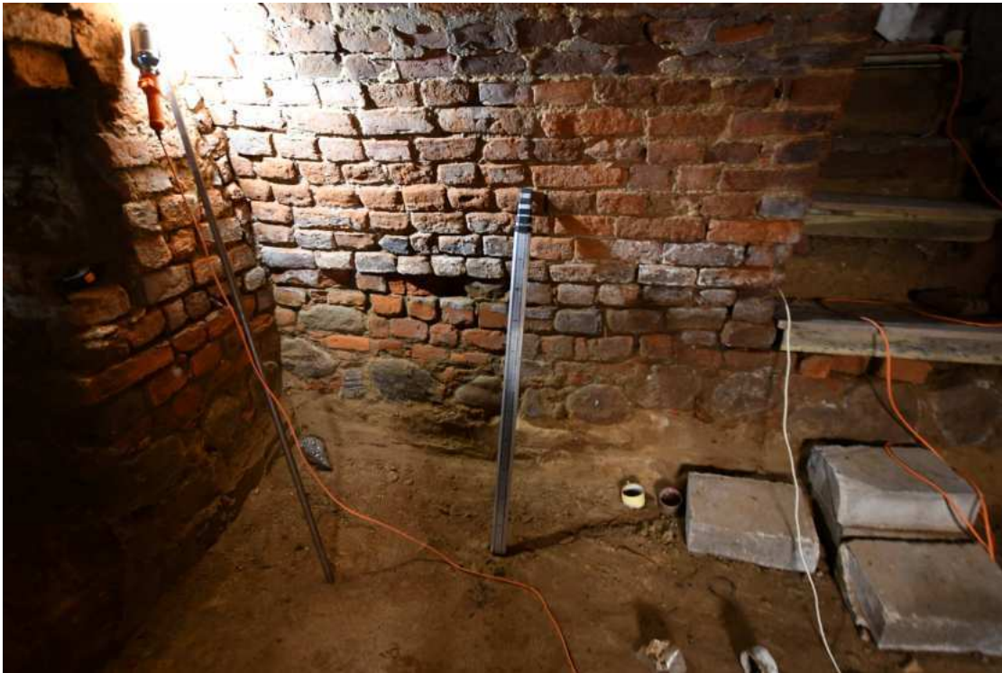
Fot. 2. Kazimierz Biskupi, kościół pw. Św. Jana Chrzciciela i Pięciu Braci Męczenników, krypta 1., stan zachowania: zanieczyszczenie lica kamiennego, pozostałości zapraw, zasolenie lica ceglanego, ubytki spoin i cegieł, zachowane relikty historycznych zapraw
