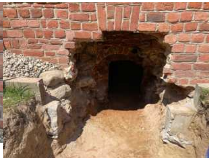
Fot. 3 Rozkuty otwór widok od zewnątrz, widoczna rura przechodząca przez łęk
